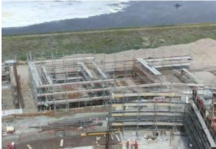
Sala Eléctrica #18 y Edificio Sopladores
